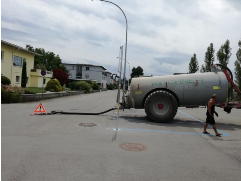
Abbildung 87: Überprüfung der Durchflussmengenmessung beim Niederschlagswasserkanal Langackerweg/Hard durch Einleitung einer definierten Wassermenge und Vergleich mit der angezeigten Menge © Umweltinstitut
