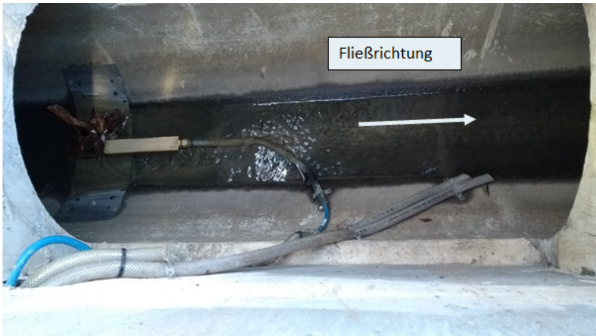
Abbildung 58: Installationsort des Durchflussmesssystems und des Ansaugpunkts für die automatische Probenahme an der Messstelle Graz – Ziegelstraße © TU Graz
